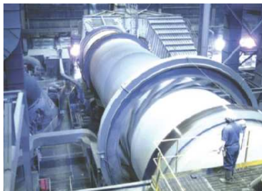
Figura 6: Horno en la Planta Minntac
